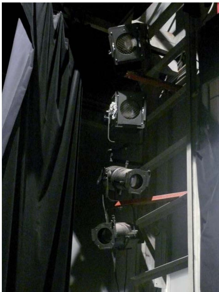
Světelné vybavení na jevišti
