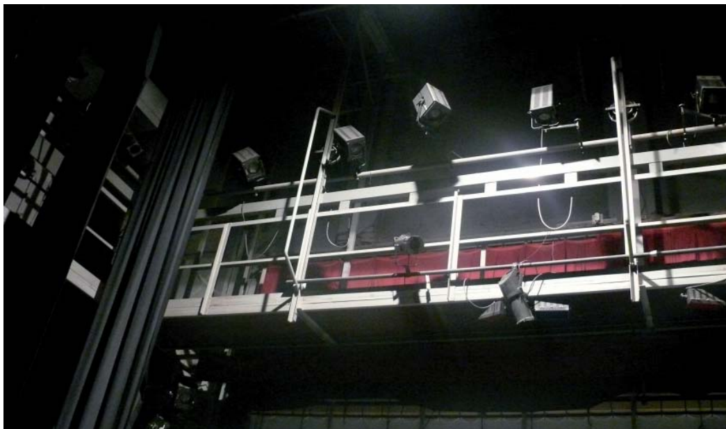
Světelné vybavení na jevišti
