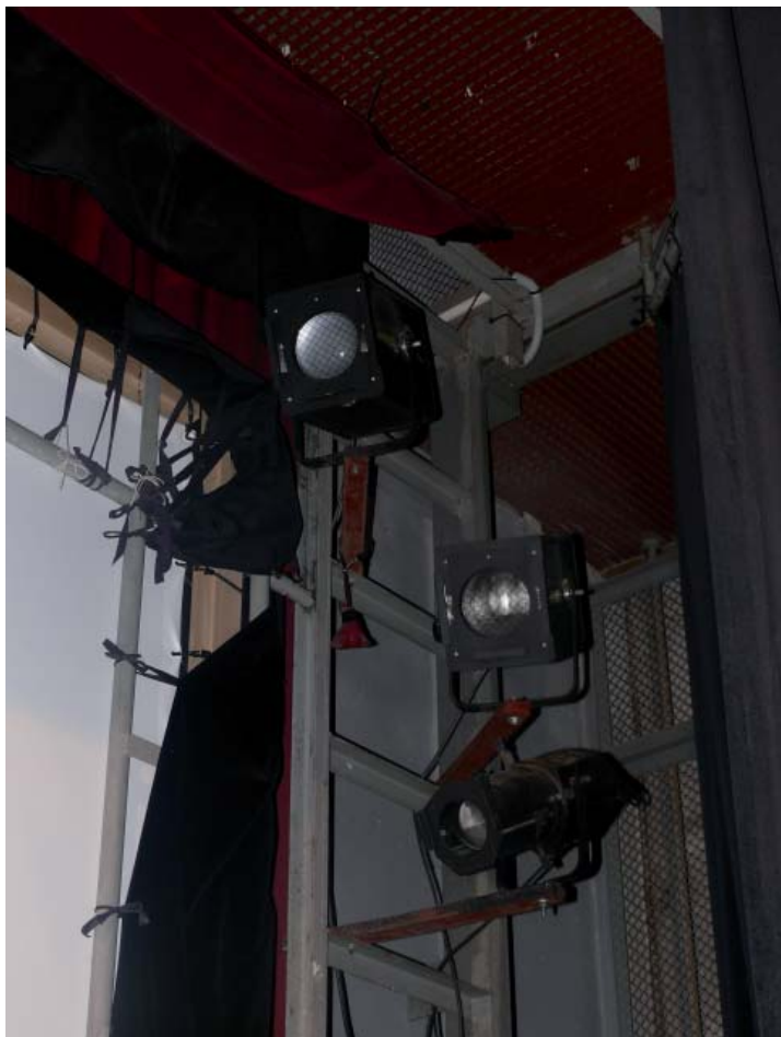
Světelné vybavení na jevišti
